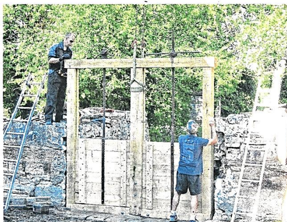
➔ De gauche à droite : c'est au millimètre près qu'il a fallu ajuster les différentes pièces des vannes du moulin ; dont voici le résultat quelques jours après la pose.
