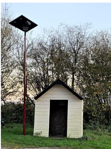
Eclairage autonome des abris-bus
